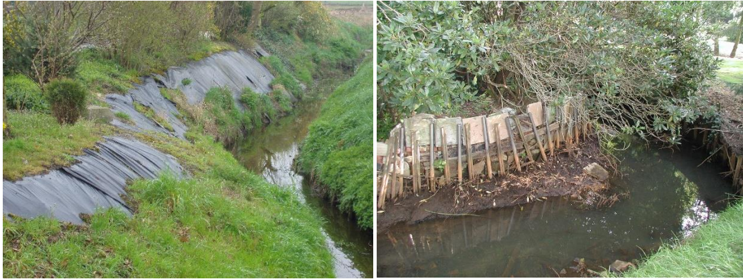
Figuur 12: Voorbeeld van niet gemachtigde oeverherstellingswerken
